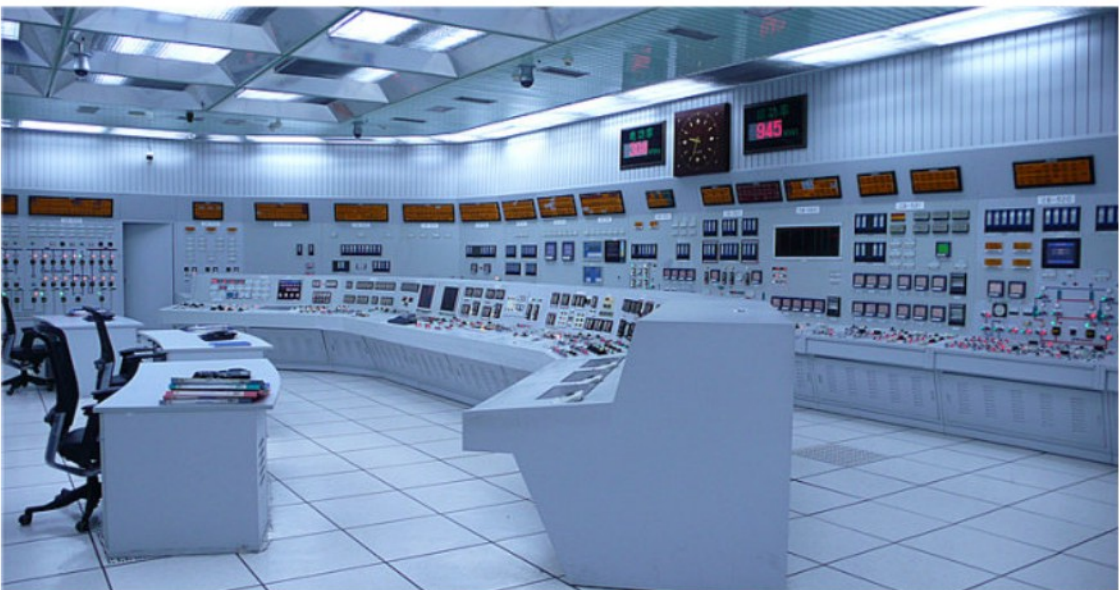
综合监控系统
